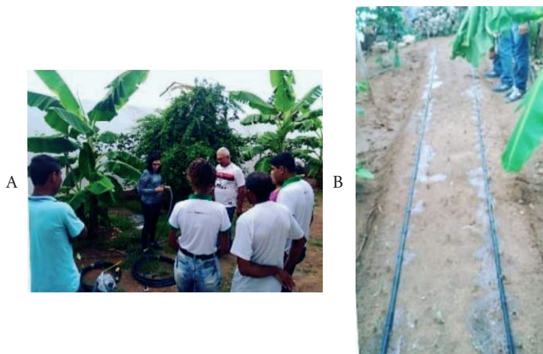
Figura 1 – (a) Processo de montagem do sistema de irrigação de baixo custo modelo Xique-Xique; (b) Sistema de irrigação modelo xique-xique em funcionamento
