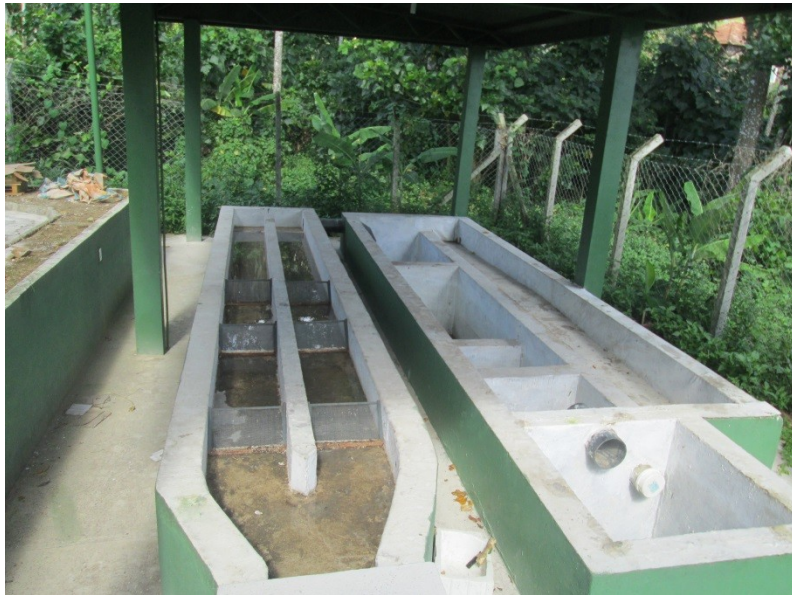
Figura 22 - Estação de Tratamento de Efluentes
